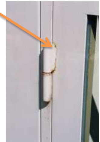
Soudure non continue avec caniveau profond Après 6 ans 10 mois
