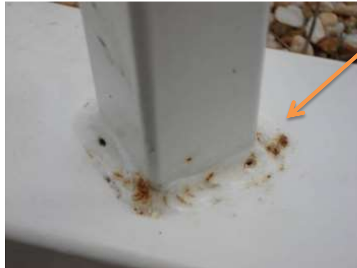
Soudure irrégulière et poreuse Après 2 ans
